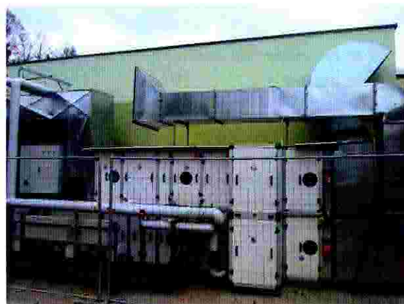
Centrala wentylacyjna do Bloku Operacyjnego
